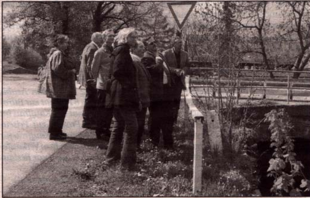
Die Staatsstraßen bedürfen vielerorts einer Erneuerung. Anfang Mai fand eine Begutachtung des Straßennetzes mit der Landtagsabgeordneten Simone Raatz und Landrat Uhlig statt. Foto: LRA / Minovsky
